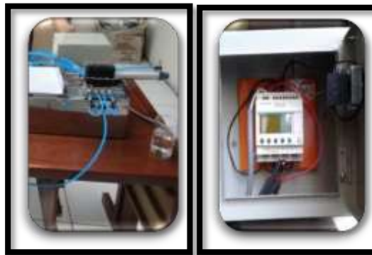
Figura N° 6: Elementos del PLC
